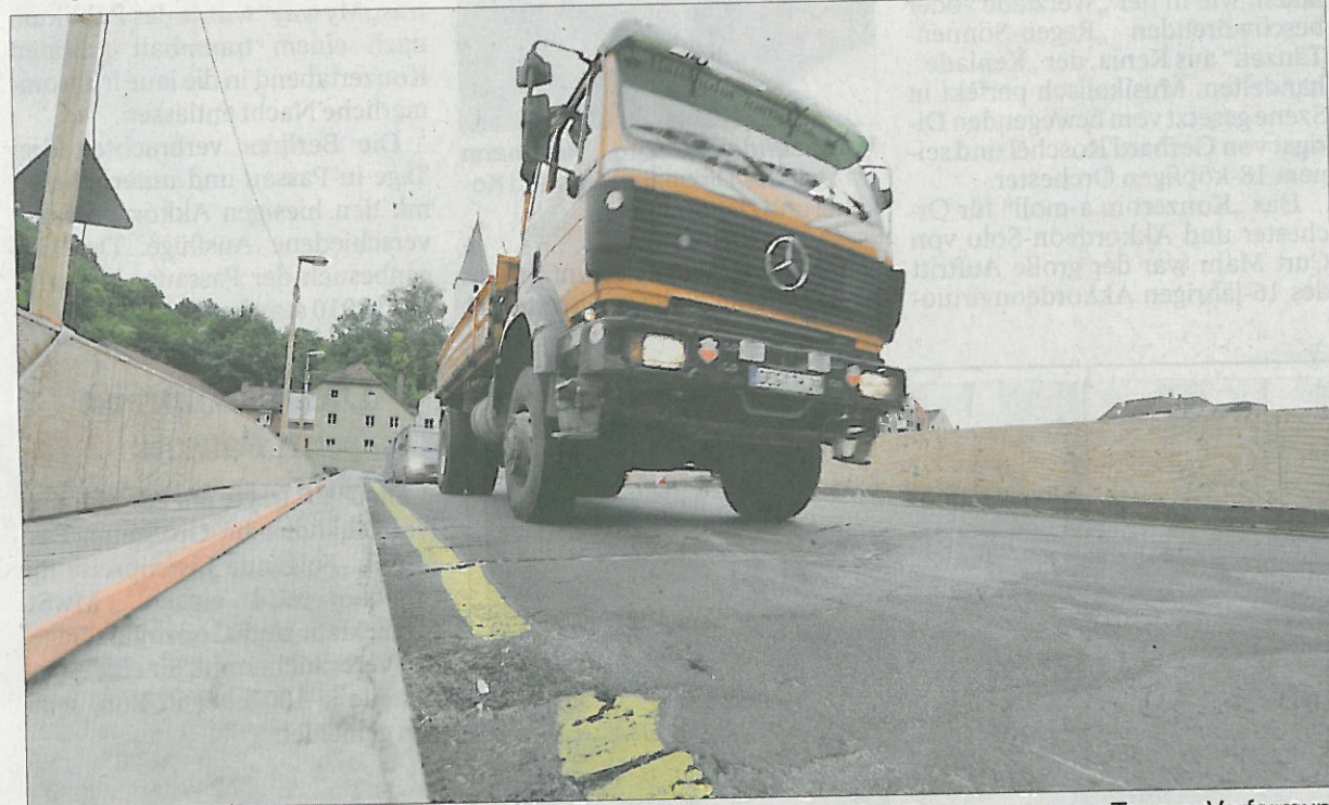
Asphalt-Wellen über der Ilz: Auf der Behelfsbrücke haben Lkws und die Hitze vergangener Tage zu Verformungen des Belags geführt. In einer Nachtschicht sollten sie bis heute Morgen ausgebessert werden. – Foto: Geisler
