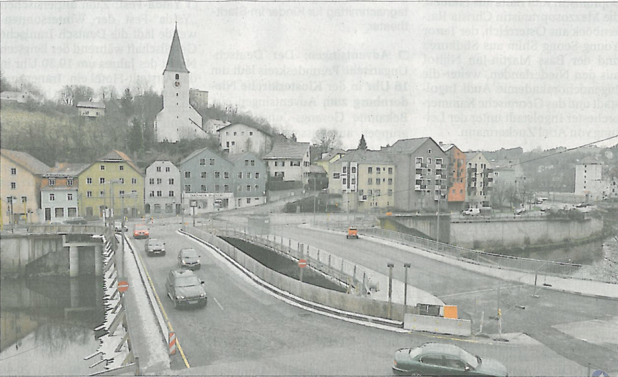
Die Behelfsbrücke in Betrieb, die neue Ilzbrücke dahinter kurz vor der Vervollendung.
